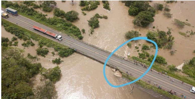
Figura 1. Representação dos processos de Enchente, inundação, alagamento e rompimento do primeiro trecho da BR 316, na Vila do Caeté, Santa Luzia do Pará - PA.
